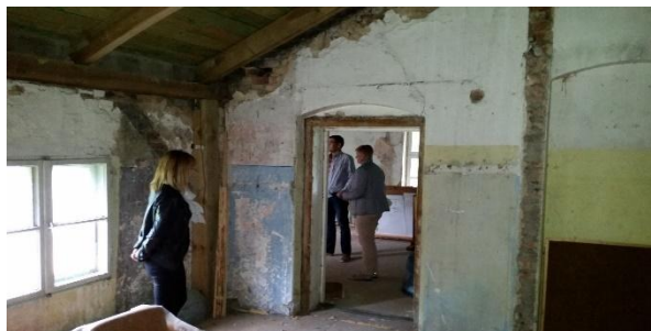
Fot.5 Niewykorzystane poddasze zabytkowego pałacu.
